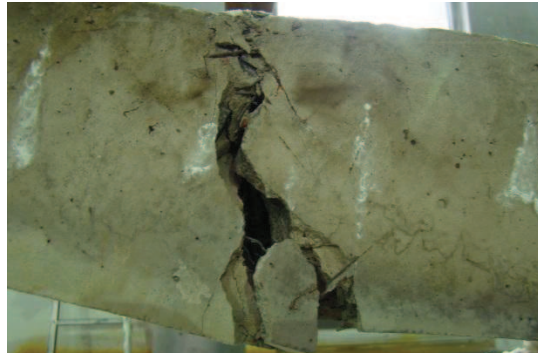
(f) Concrete fracture (HFRCJ3)
