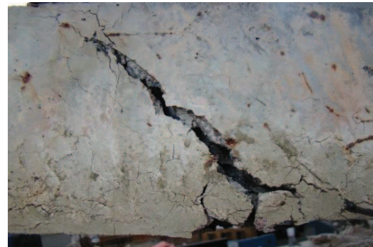
(d) Concrete fracture (HFRCJ6)
