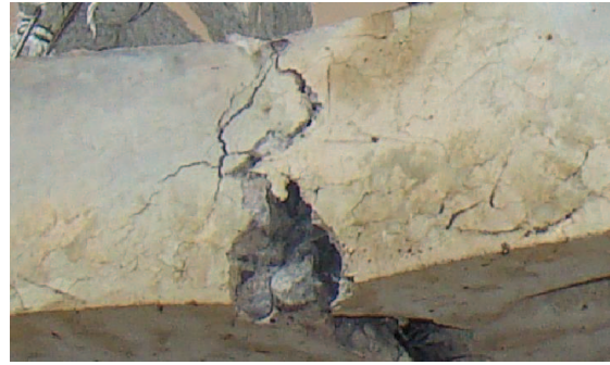
(b) Concrete fracture (HFRCJ5)
